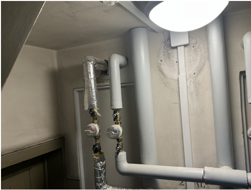
Utæt gennemføring mellem bagtrappe og lejlighed omkring VVS installation
