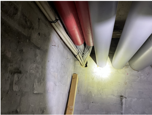
Utæt gennemføring i kælder omkring kabler
