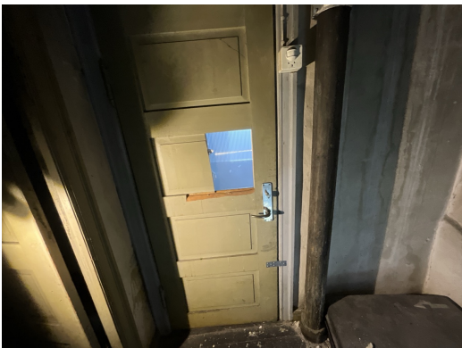
Defekt dør mellem loftrum og bagtrappe
