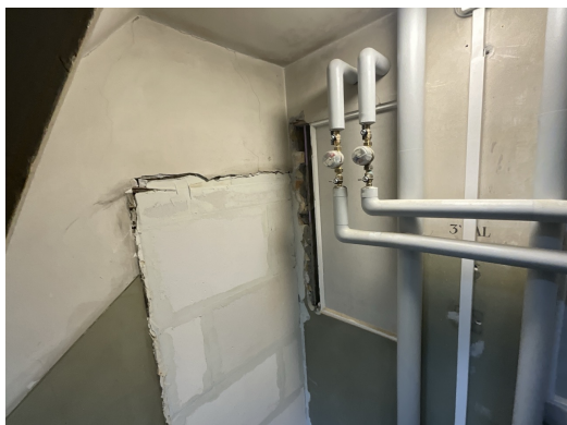
Skade på puds op trappe
