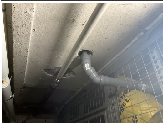
Afløbsinstallation i plastik i kælder
