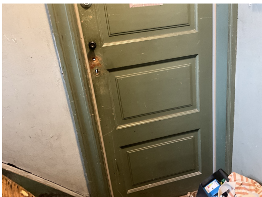
Dør på bagtrappe som ikke er tætsluttende
