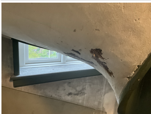
Skade på puds op trappe
