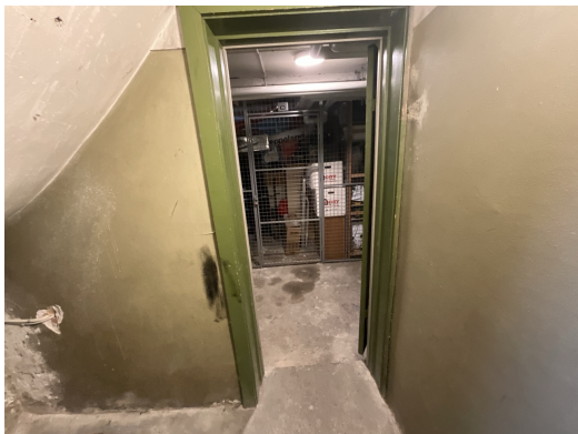
Åbenstående dør mellem bagtrappe og kælder
