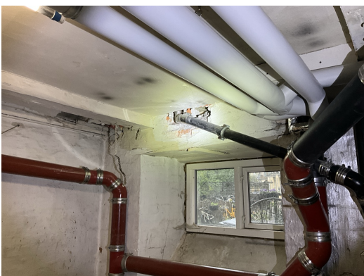
Utæt gennemføring mellem hælde og stueetage
