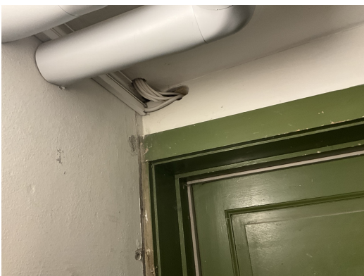
Utæt gennemføring mellem trappe og kælder omkring kabler
