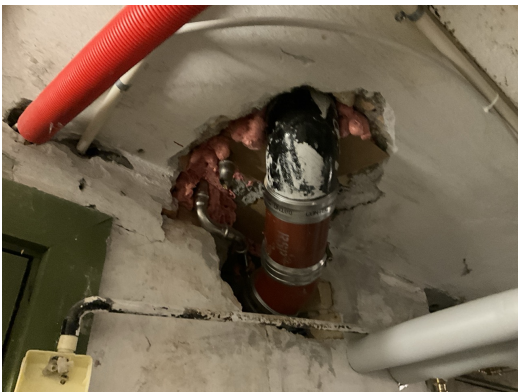
Utæt/opskummet gennemføring i kælder, skum er formentlig ikke testet og godkendt til denne type tætning
