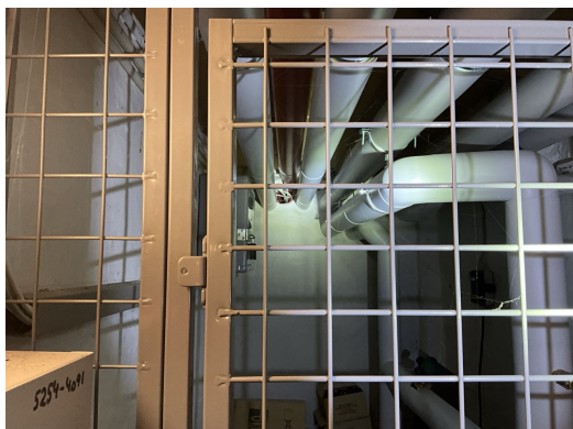
Utæt gennemføring i kælder omkring kabler
