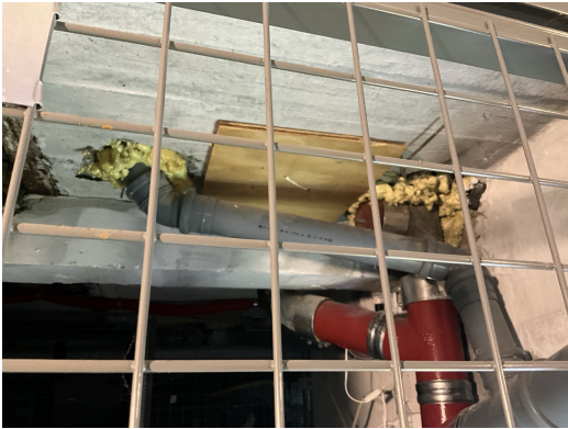
Defekt overflade i kælder
