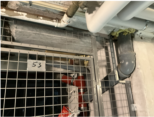
Afløbsinstallation i plastik i kælder
