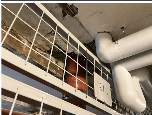
Utæt gennemføring i kælder omkring VVS installation
