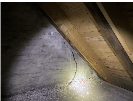
Utæt gennemføring i loftrum omkring kabel
