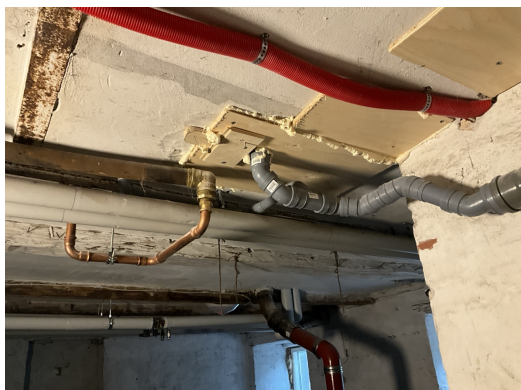
Afløbsinstallation i plastik i kælder
