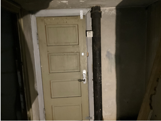
Dør til loftrum som ikke er tæt omkring tidligere lås
