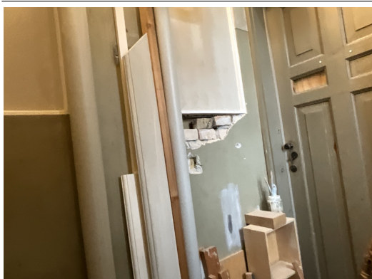
Skade på puds op trappe
