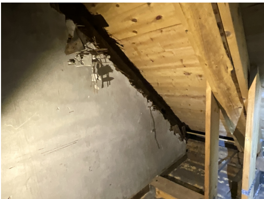
Væg der ikke er afsluttet mod undertaget eller brandkam/brandkamsersætning i tagrummet.
