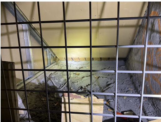
Blotlagte brædder på underside trappe i kælder
