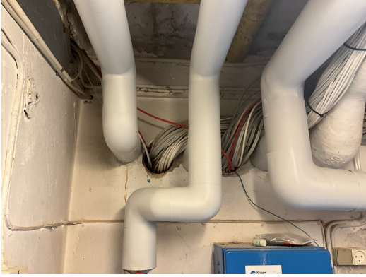
Utæt gennemføring i kælder omkring kabler
