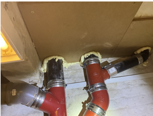
Defekt overflade i kælder og skum som lukning
