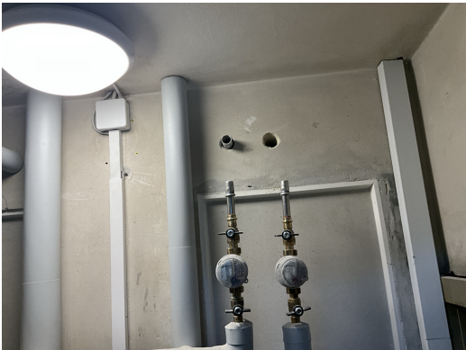
Hul mellem bagtrappe og lejlighed omkring VVS installation
